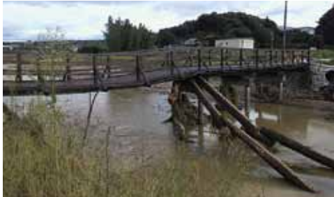
橋脚が崩壊した二野の木橋
