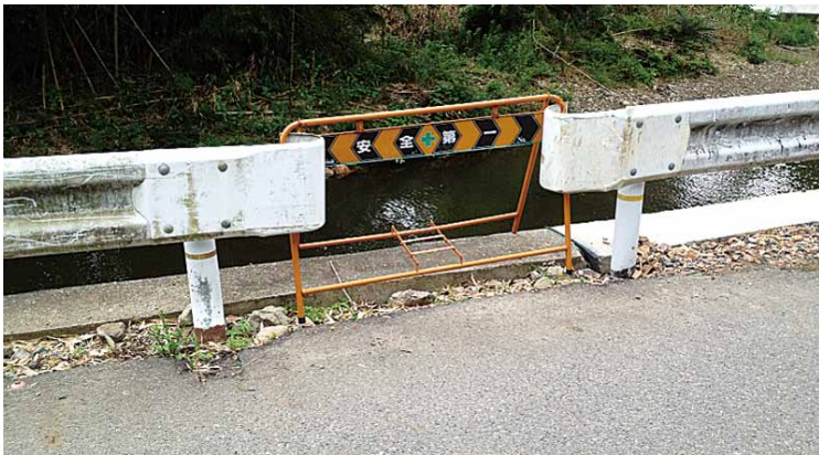
ガードレールの隙間も修繕予定
